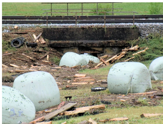
Abb. 7: Verklauung eines Durchlasses unter einer Bahnlinie mit Silageballen und Holz Foto: WWA Ansbach, 2016
